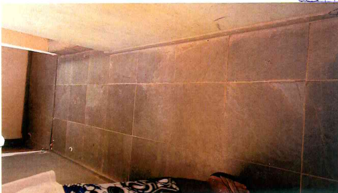
PISO DO CORREDOR ENTRE OS APTO 06 E 08.
