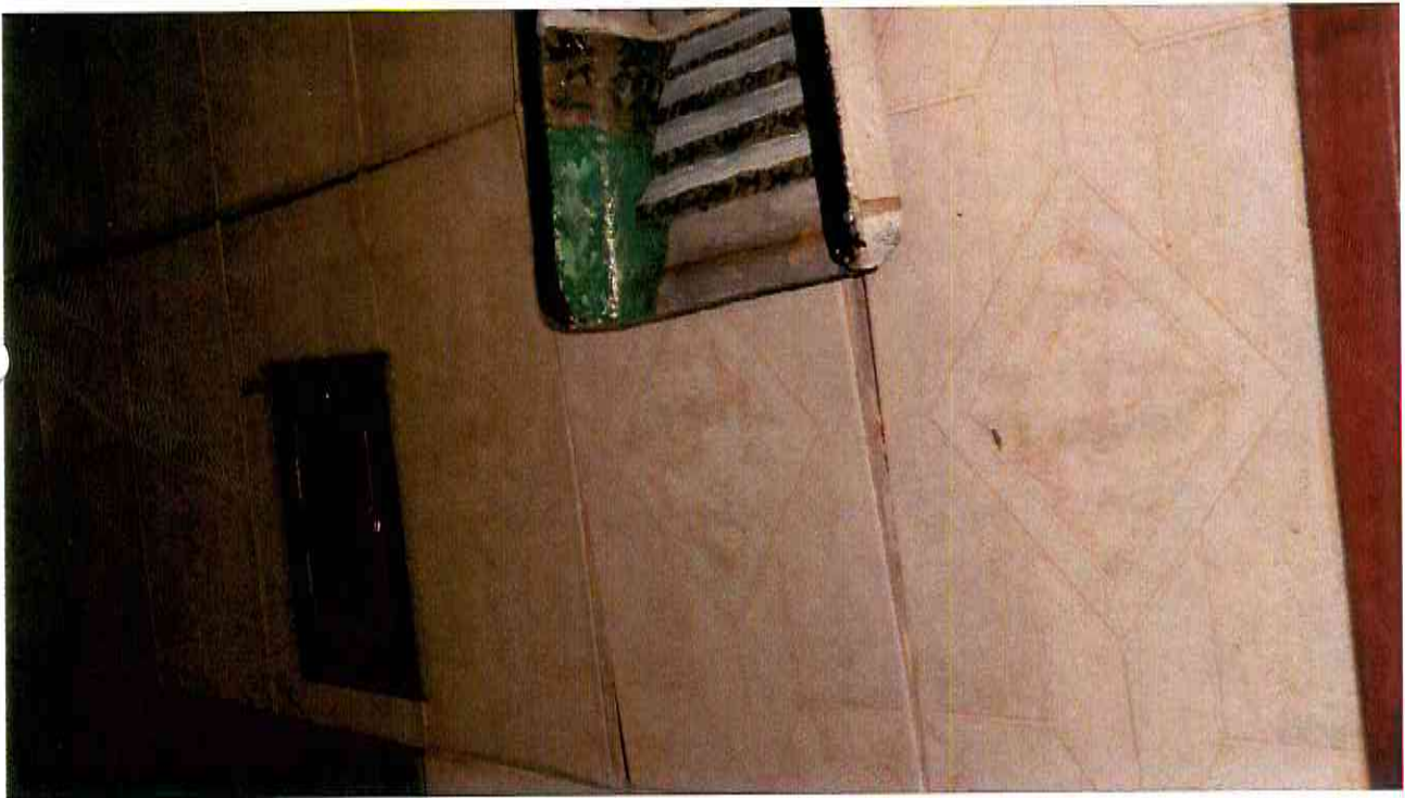
AZULEJOS SE DESPRENDENDO DA PAREDE DA COZINHA.
