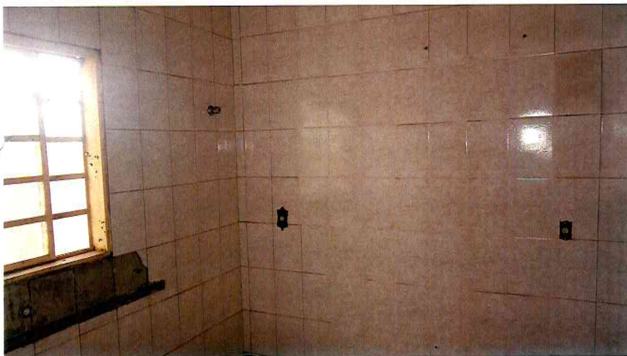
COZINHA. (OBS: AZULEJOS SE DESPRENDENDO DA PAREDE).
