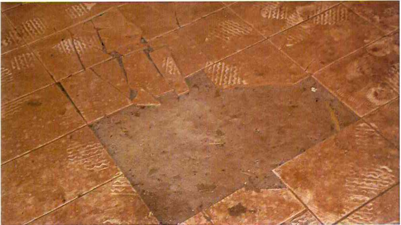
PISOS DA SALA QUEBRADOS.
