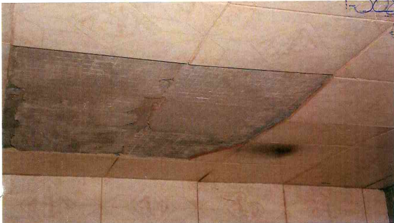
DESCOLAMENTO DOS AZULEJOS. (COZINHA).
